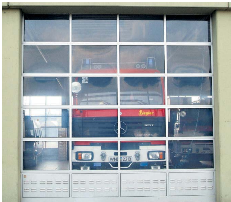
Die St. Wendeler Feuerwehrtore sind bereits rund 30 Jahre alt. Sie sollen erneuert werden: Mit eigenem Haushaltstitel oder aus dem Verwaltungshaushalt, war die Streitfrage.
